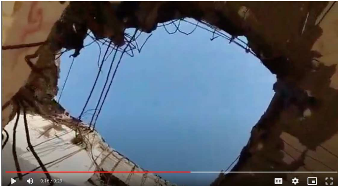
صورة 29: لقطة مثبتة من مقطع فيديو تظهر ثقب سببه القصف الجوي لسطح مبنى المدرسة.
